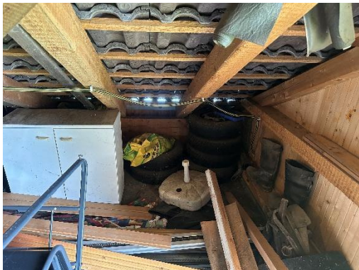
Bild 9: Innenraum des Dachstuhls mit Lücken unterhalb der Ziegelabdeckung in der Doppelgarage (H. Röske, 27.05.2025)
