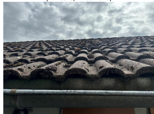
Bild 14: Ziegelabdeckung der Doppelgarage (H. Röske, 27.05.2025)
